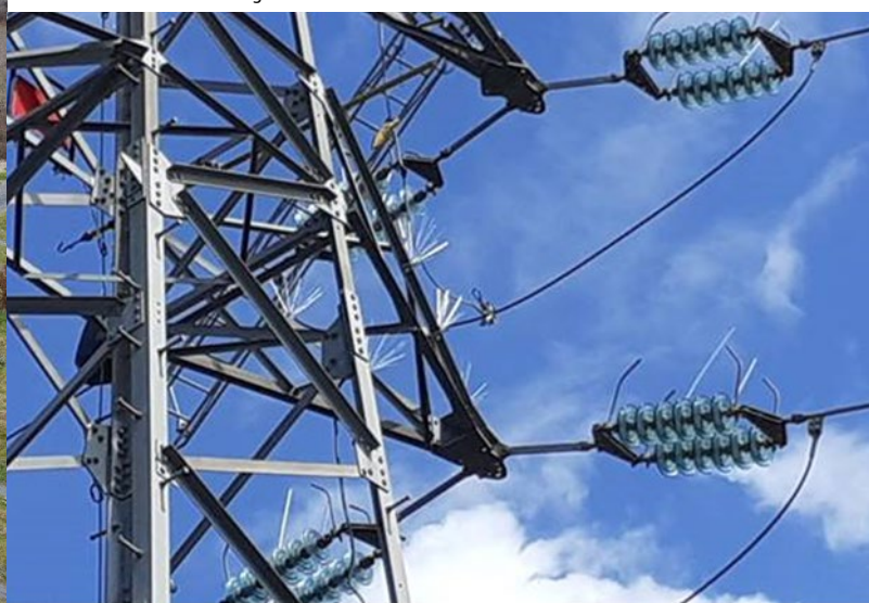
Photo 2 : Les pics pour l'avifaune installés sur les consoles basses et les tiges en téflon sur les chaînes d'ancrage - © RTE
