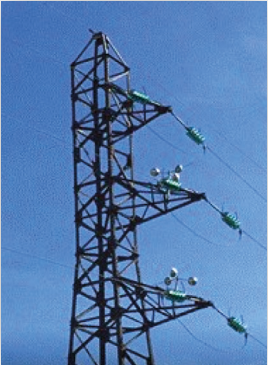
Pylône équipé de girouettes dissuasives
