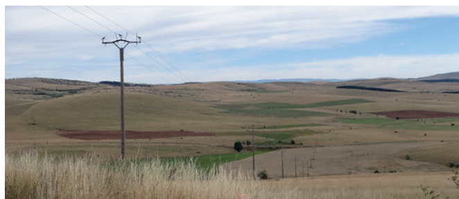
Tronçon électrique © S. Jude
